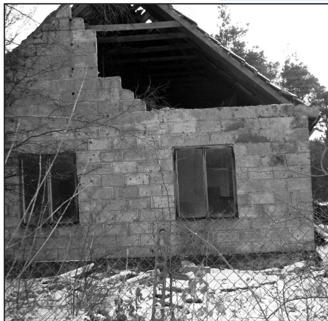
Wichura uszkodziła dom mieszkalny w Dudkowie.
