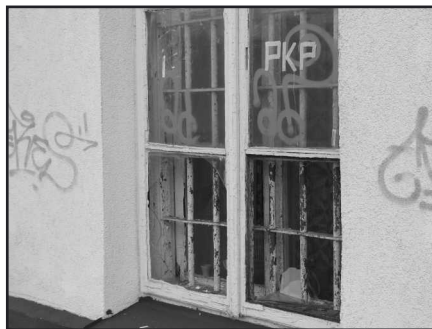
Wybita szyba w oknie dworca, od strony peronów
