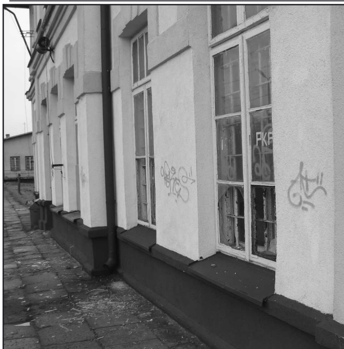
Potłuczone szyby, pomalowana elewacja – oto wizytówka stacji Zagnańsk
